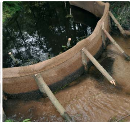
Filtre à sédiments* en fibre de coco, celui ci permet de capter les matières en suspension dans l'eau et faciliter leur dépôt
