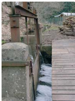
Ouvrage hydraulique : prise d'eau en barrage sur la rivière
