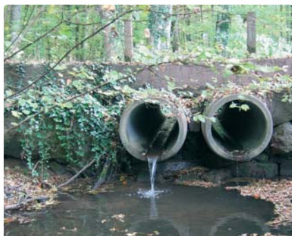
Rupture de la continuité écologique* suite à un busage mal conçu
