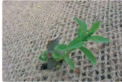
Bouturage de saule pour fixer rapidement le talus des berges - Service rivière - CG67
