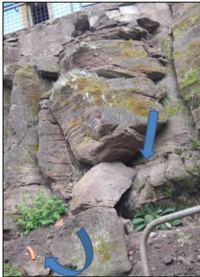
Illustration 25 : Photographie d'une colonne présentant une susceptibilité à une rupture en pied de colonne
