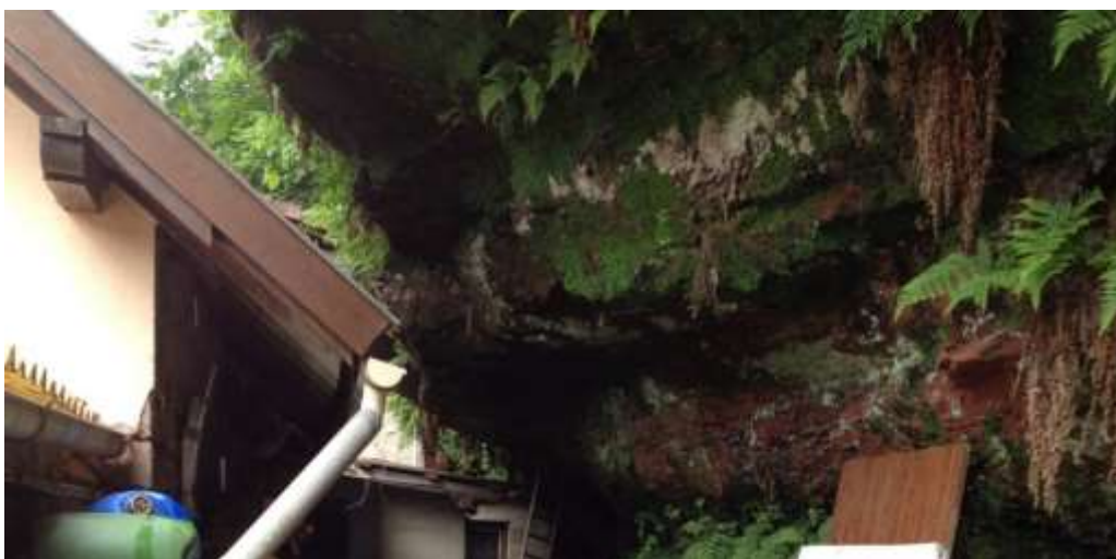
Illustration 15 : Le phénomène de sous-cavage, facteur de prédisposition à l'aléa « chute de blocs »
