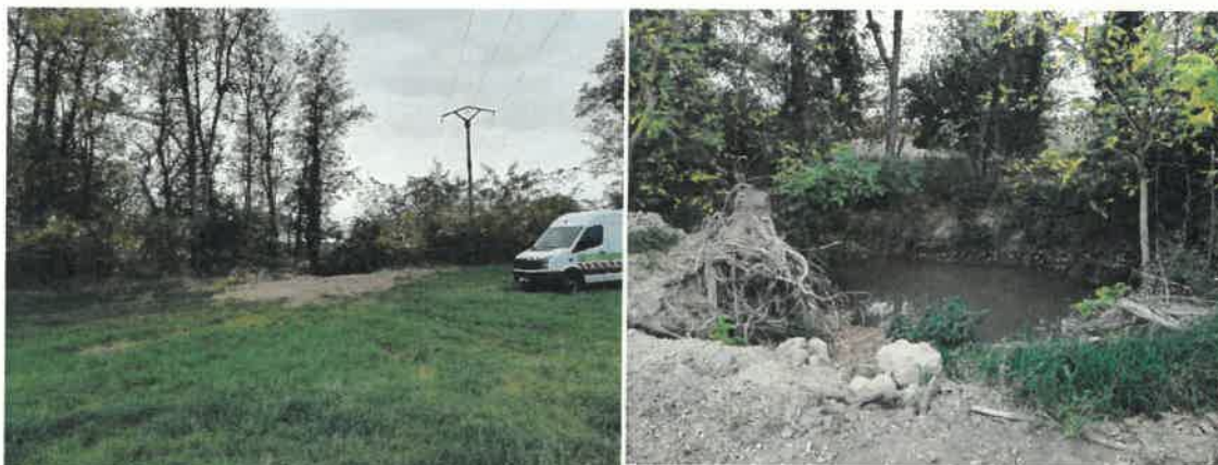
Etat de la brèche en octobre 2018
