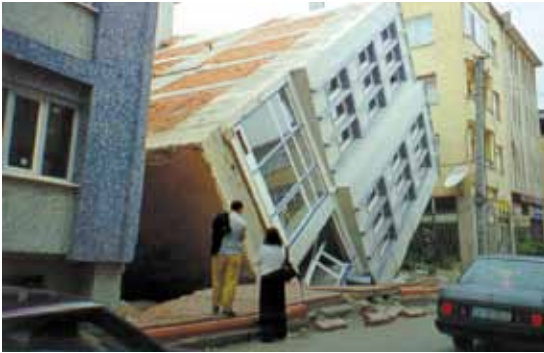
↳ Séisme d'Izmit (Turquie) : perte de portance par liquéfaction du sol lors du séisme du 17 août 1999
